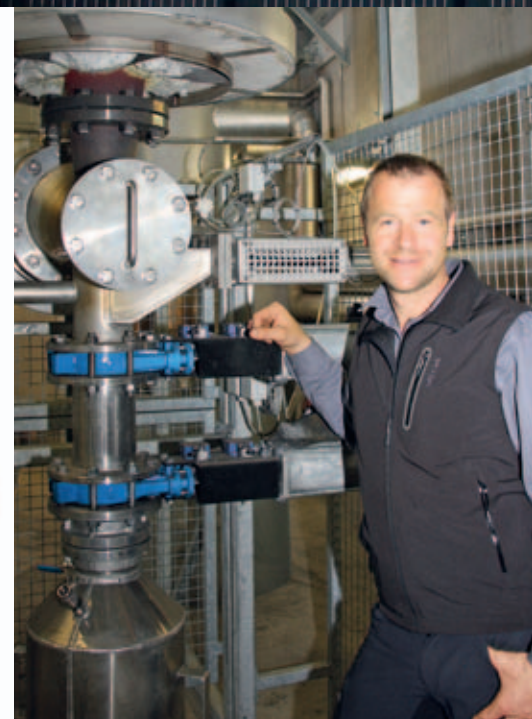
Der entgegen der Schwerkraft betriebene Vergasungsreaktor ist das Herzstück der Anlage.
