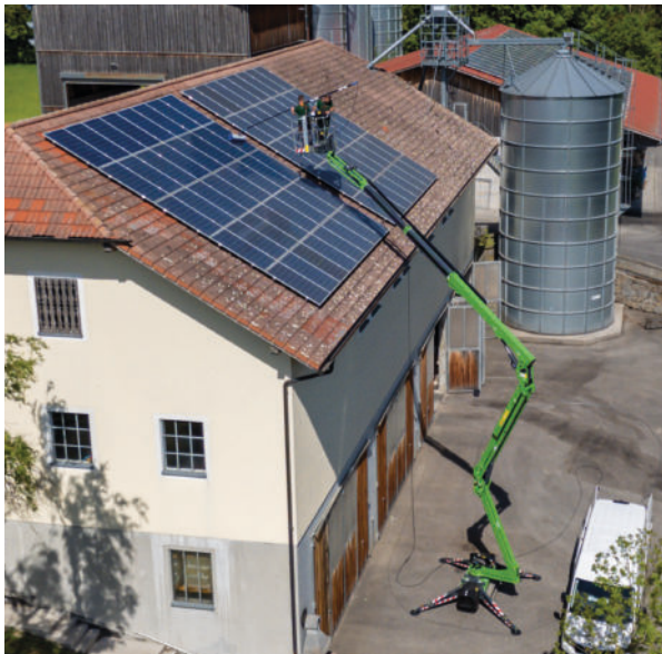
Andreas und Peter sorgten für saubere Paneele beim Dach des Hausrücköl-Lagers in Aistersheim.
